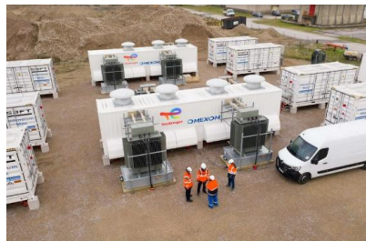
Site de capacité de stockage stationnaire de 61MWh à Dunkerque @TotalEnergies)
